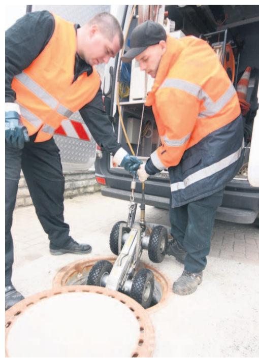
Mitarbeiter einer Fachfirma lassen im März an der Fünfhausenstraße einen Roboter hinab in die Kanalisation. Inzwischen liegen die Ergebnisse der aufwändigen Analysen vor. Foto: ric
